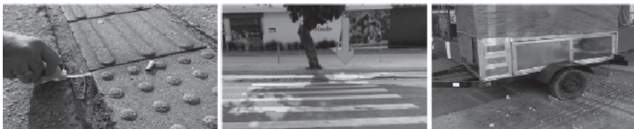
Figura 6 - Vão superior a 15mm não nivelado na instalação do piso tátil; Rampa de acesso à calçada desalinhada com a faixa de pedestres; Obstáculo móvel restringindo a circulação a menos de 1,5m
