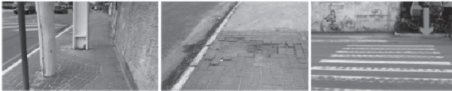
Figura 5 - Poste deixando menos de 1,5m livre para circulação; Buraco na calçada; Rampa de acesso desalinhada com a faixa de pedestres
